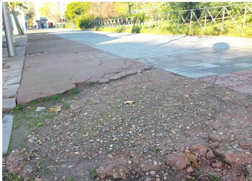
Carril bici deteriorado en el PAU de Carabanchel
